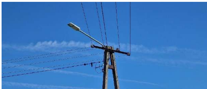
Energooszczędna oprawa oświetlenia ulicznego w miejscowości Grodzisk-Wieś
