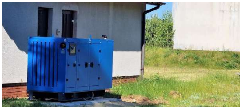
Nowy agregat prądotwórczy na terenie SUW Czerwin
